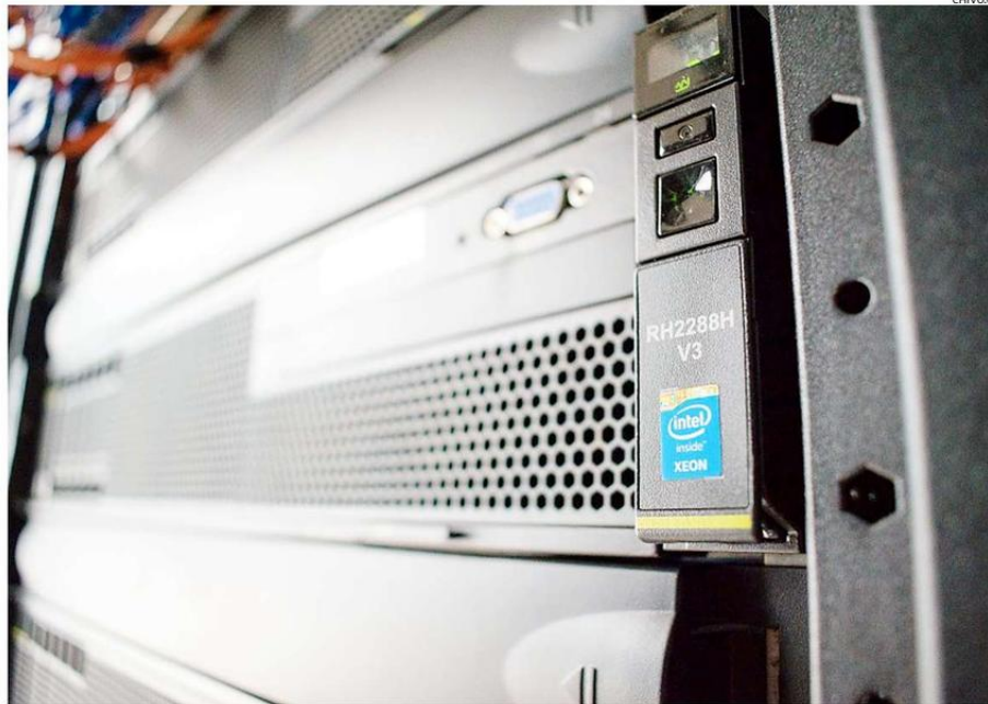
ESTE ES UNO DE LOS SERVIDORES DE ALMACENAMIENTO Y, A NIVEL LATINOAMERICANO, ES EL DE MAYOR CAPACIDAD PARA DATOS ASTRONÓMICOS.
